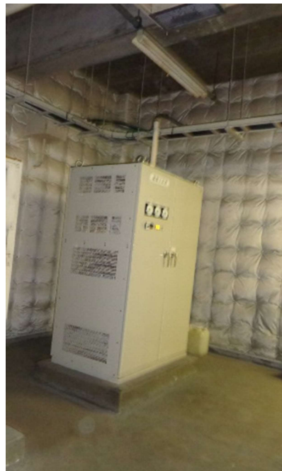
非常用蓄電池設備
