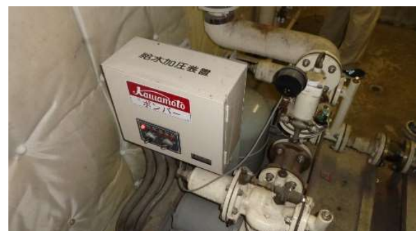
加圧給水ポンプ
