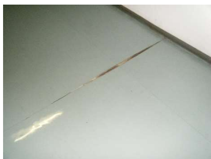
ビニル床シート継ぎ目の剥離
