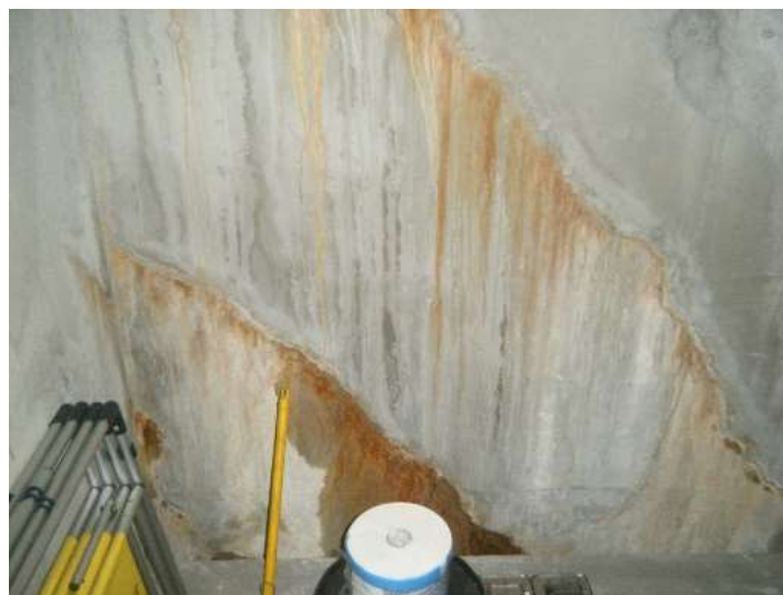
エレベーター機械室壁ひび割れ
