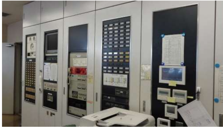
自動火災報知設備受信機
