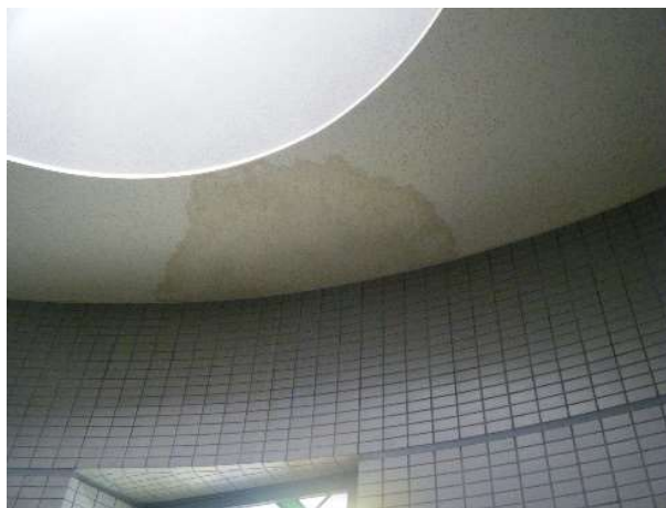
トップライトからの雨漏り跡（階段室）
