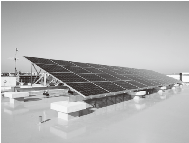
新栄小学校の太陽光発電
