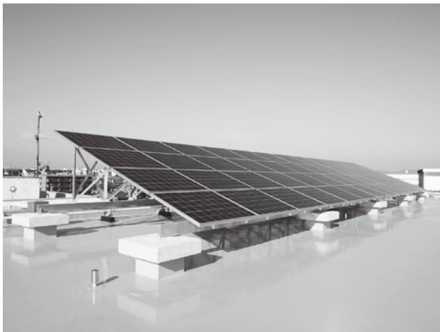
新栄小学校の太陽光発電
