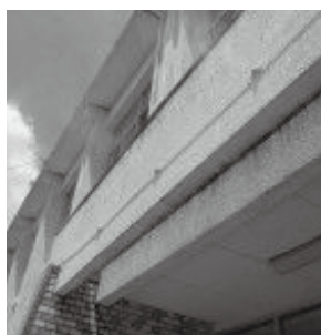
日進市北小学校のミストシャワー
