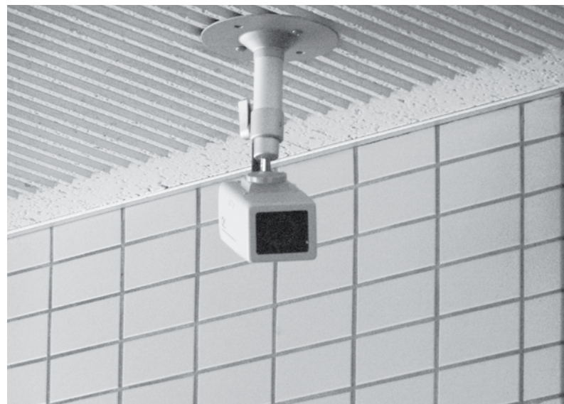
社教センターに設置されている防犯カメラ
