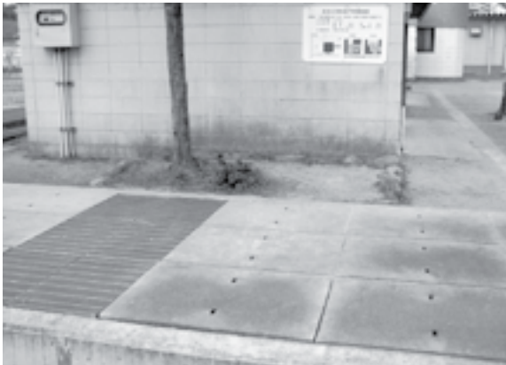
志水小学校に設置した雨水貯留施設
