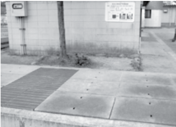
志水小学校に設置した雨水貯留施設
