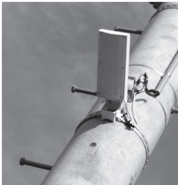
LEDになった防犯灯
