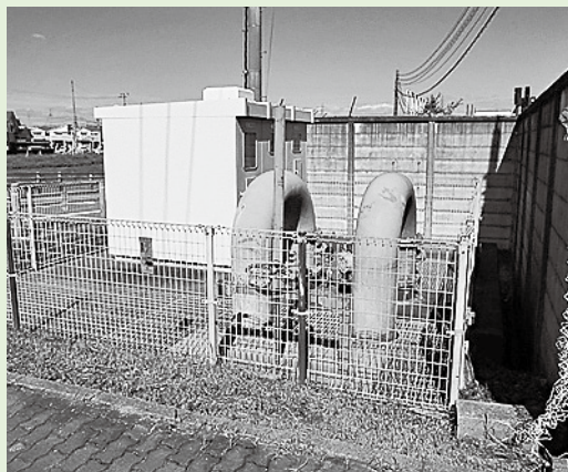
▲ポンプ更新工事
