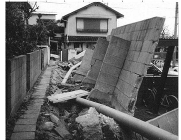
地震によるブロック塀の倒壊
