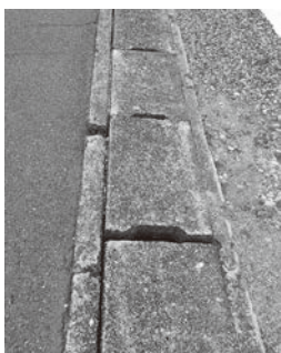
ひび割れている側溝
