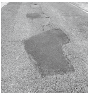
目立つ継ぎはぎ舗装
