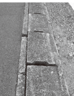
ひび割れている側溝
