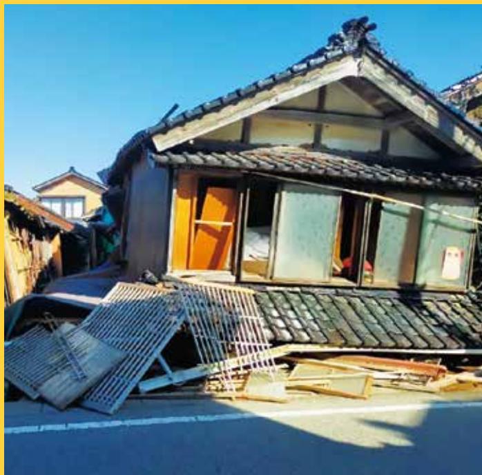
▲石川県志賀町(しかまち)の被害の様子 「倒壊した家屋」
