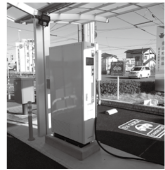
役場駐車場のEV充電器
