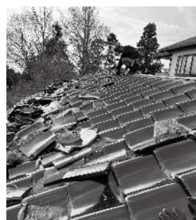
落下の危険もある瓦
